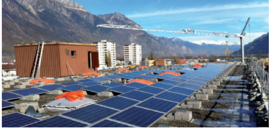
Les modules solaires sur le toit des Caves Orsat à Martigny.
